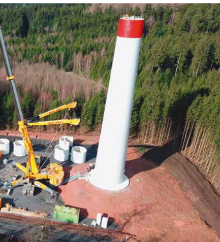
Bauteil für Bauteil wächst der Turm in die Höhe (kleines Fotos). Im August konnte dann die Abnahme der Anlagen stattfinden (großes Foto).
